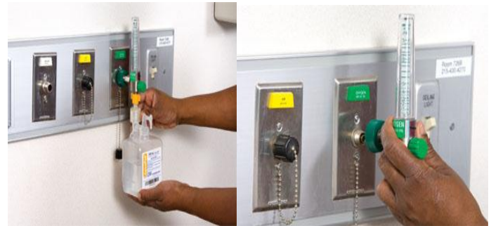
سیلندر اکسیژن و مانومتر را چک و بررسی کنید (از نظر پر بودن کپسول و عدم نشتی و وجود آب مقطر در سیستم مرطوب کننده)
